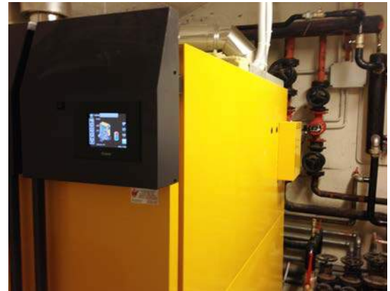
La ETA HACK 200 a cippato installata
